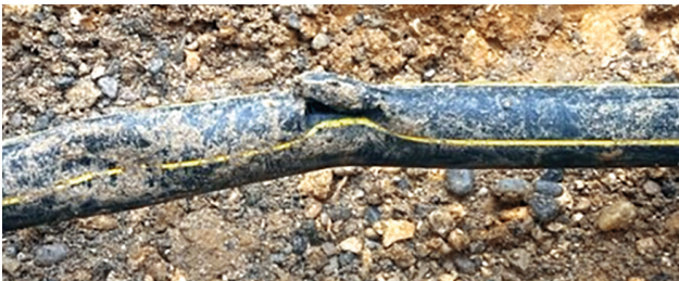
Beschädigte und nicht mehr betriebssichere Rohroberfläche
