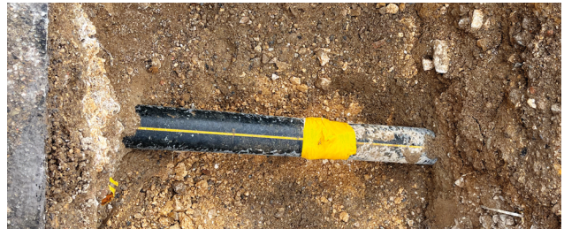
Von einem Spitzisen durchtrennte Leitung
