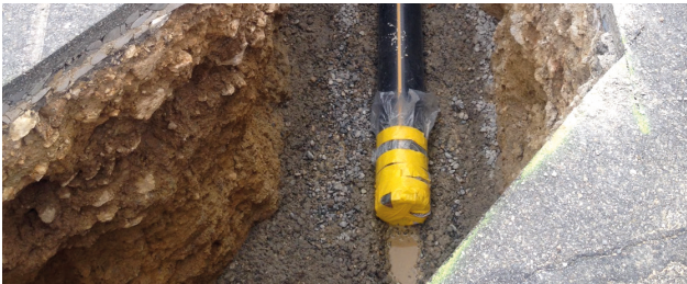
Schaden an einer Werkleitungskreuzung
